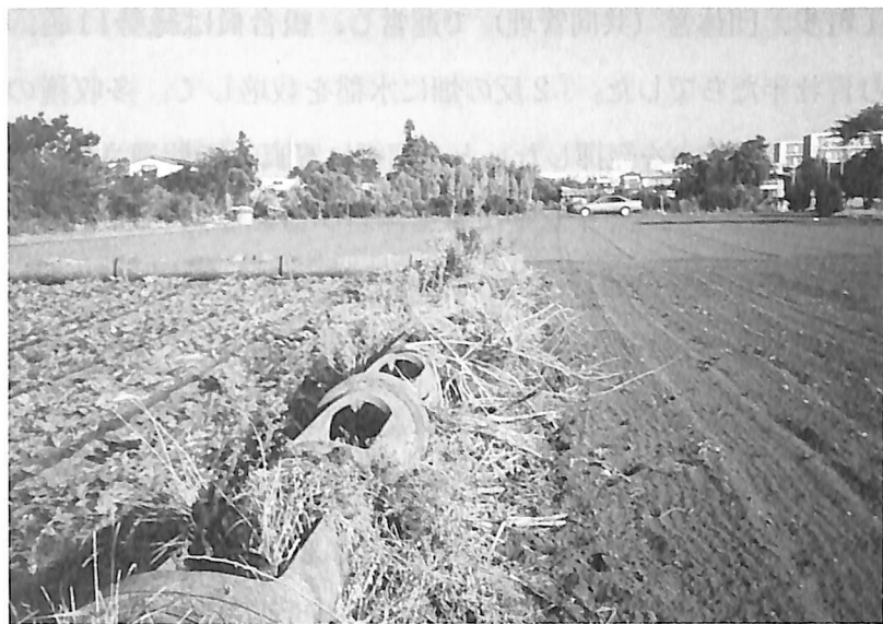
支線に使われたヒューム管
