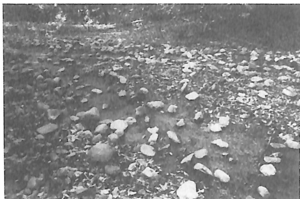
砂が流失し、水も流れていない
